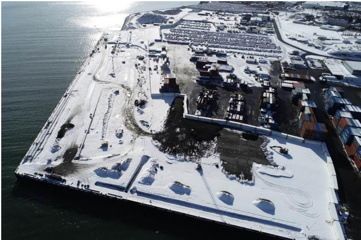
Mynd af norðurenda á nýjum hafnarbakka utan Klepps. Unnið er að frágangi yfirborðs og tengingum inn á eldri áfanga Kleppsbakka.
